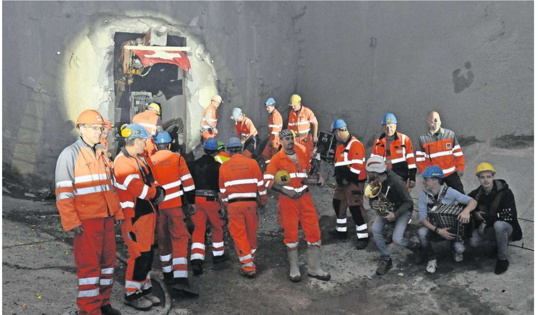
Erleichterung und Freude unter dem Schutz der heiligen Barbara: Die Mineure machten den Weg frei für die restlichen Arbeiten. Nach dem Durchschlag im Tunnel Burg in Küssnacht ernteten die Bergleute viel Applaus. Bilder: Edith Meyer
